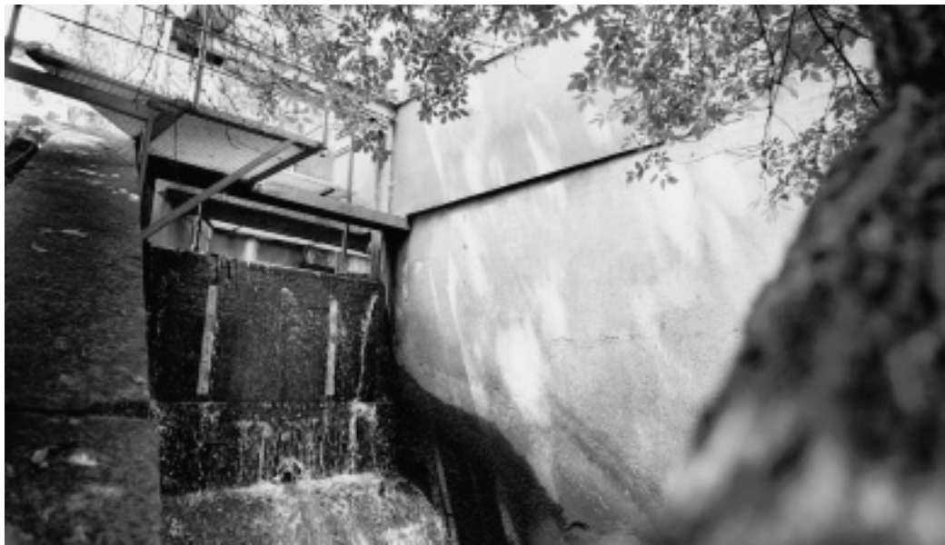
Hatausgedient: Das Wehr der Mittelsten Mühle in Stift Quernheim.
