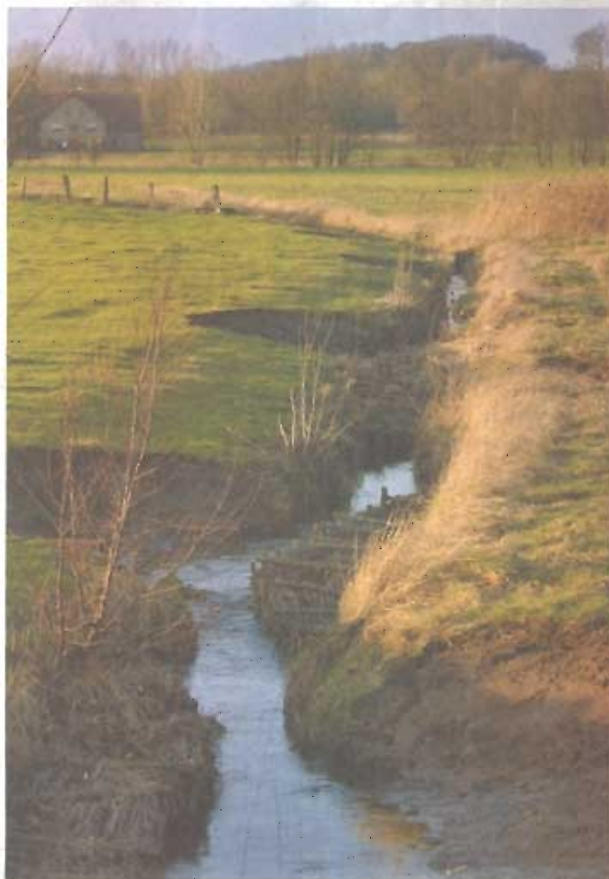
Neu: Mit wechselseitigen Abflachungen und Buschfaschinen soll die Strömung des Gewinghauser Baches gelenkt werden.
